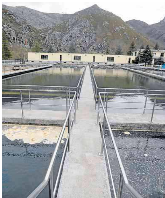
Instalaciones de tratamiento en Rioseco, explotadas por Cadasa. J. C. R.
